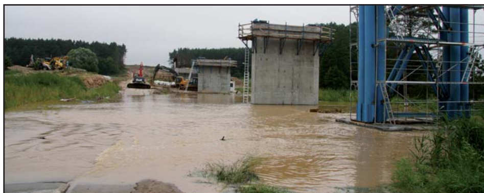
Podtopiona obwodnica w Mściszewie.
